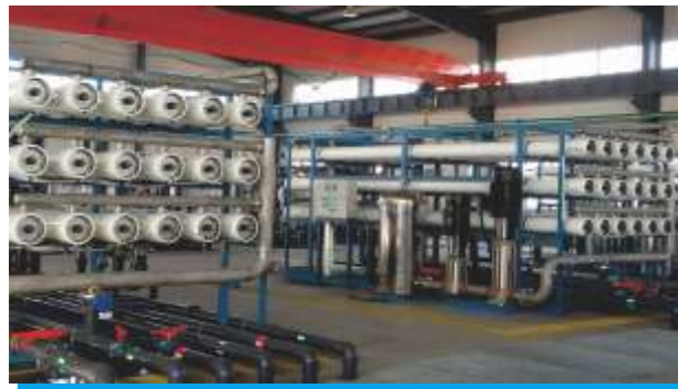
制药废水零排放(常盛) 处理量6300TPD
