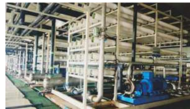
电厂脱硫废水零排放 处理量1000TPD
